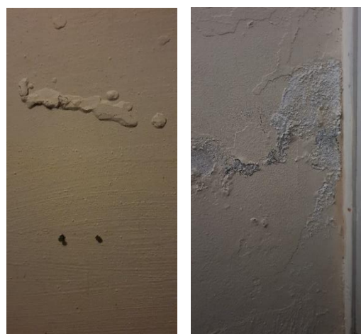
12. Kelder muur met loslatend stucwerk en uitbloei nadat de DELTA twee jaar heeft aan gestaan. De spijker-elektrodes zijn op de linker afbeelding als twee zwarte stippen te zien.
